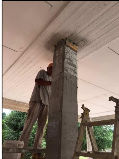
Figura 2.13 – Cerchiatura di pilastro mediante tessuto unidirezionale realizzato con rete di acciaio galvanizzato ad altissima resistenza e malta cementizia.
