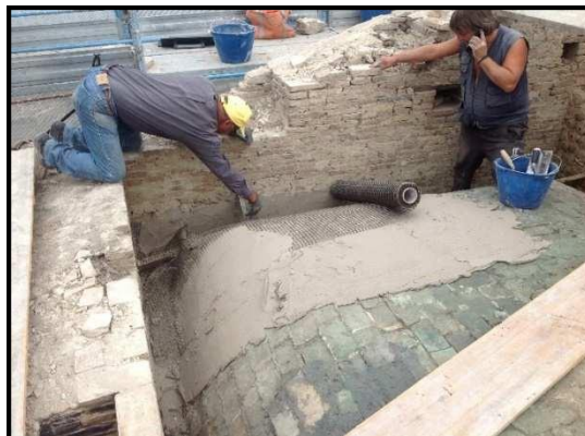
Figura 2.2 – Rinforzo estradossale di volta in foglio mediante placcaggio diffuso con rete in fibra di basalto installata con malta a base di calce idraulica.
